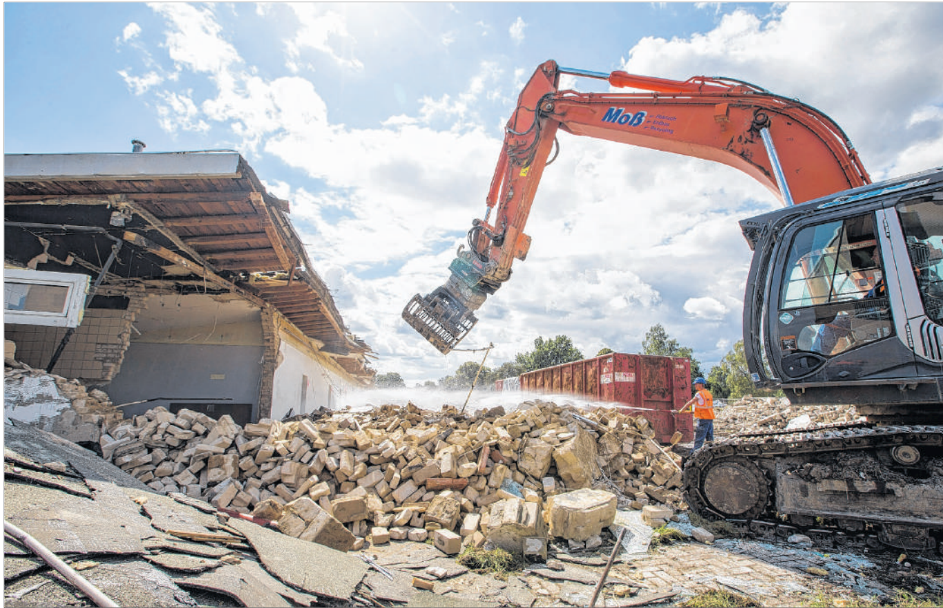
Das Ende einer Baracke: Die Abrissarbeiten auf dem Kasernengelände kommen planmäßig voran.
